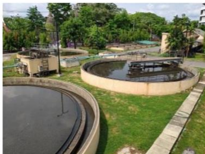
(โรงบำบัดน้ำเสีย สวนดอก)
