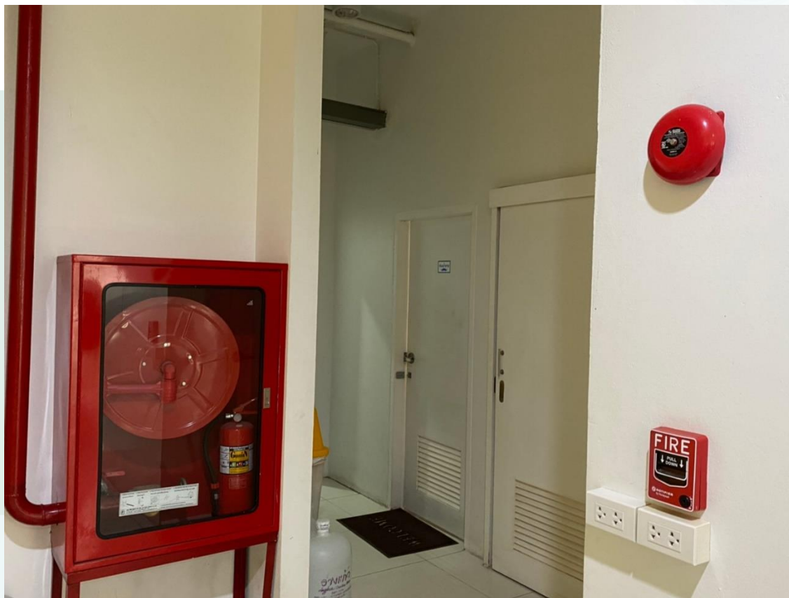
จุดติดตั้งถังดับเพลิงและสัญญาณแจ้งเตือน (ชั้น 2) บริเวณด้านหน้าห้องจัดเตรียม กอวลัม [สำนักงานมหาวิทยาลัย อาคาร 2]
