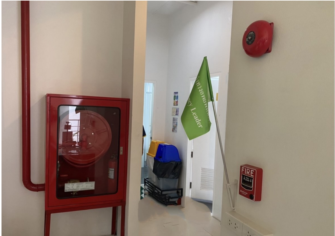
จุดติดตั้งถังดับเพลิง รมน้ำทาง และสัญญาณแจ้งเตือน (ชั้น 3) บริเวณหน้าห้องจัดเตรียม สำนักงานมหาวิทยาลัย [สำนักงานมหาวิทยาลัย อาคาร 2]
