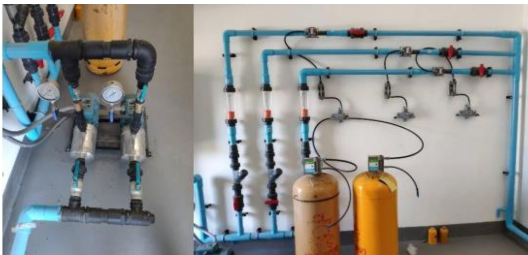
ภาพที่ 1.1 – ระบบคลอรีนที่ใช้น้ำจากการบำบัด
