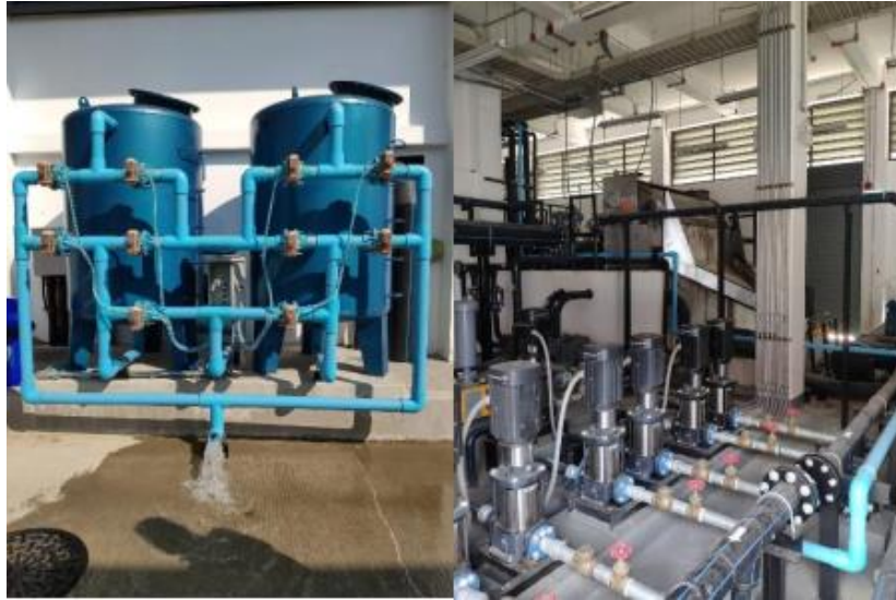
ภาพที่ 1.2 - การใช้น้ำสำหรับล้างย้อนถึงกรอง ล้างระบบท่อและเครื่องจักร
