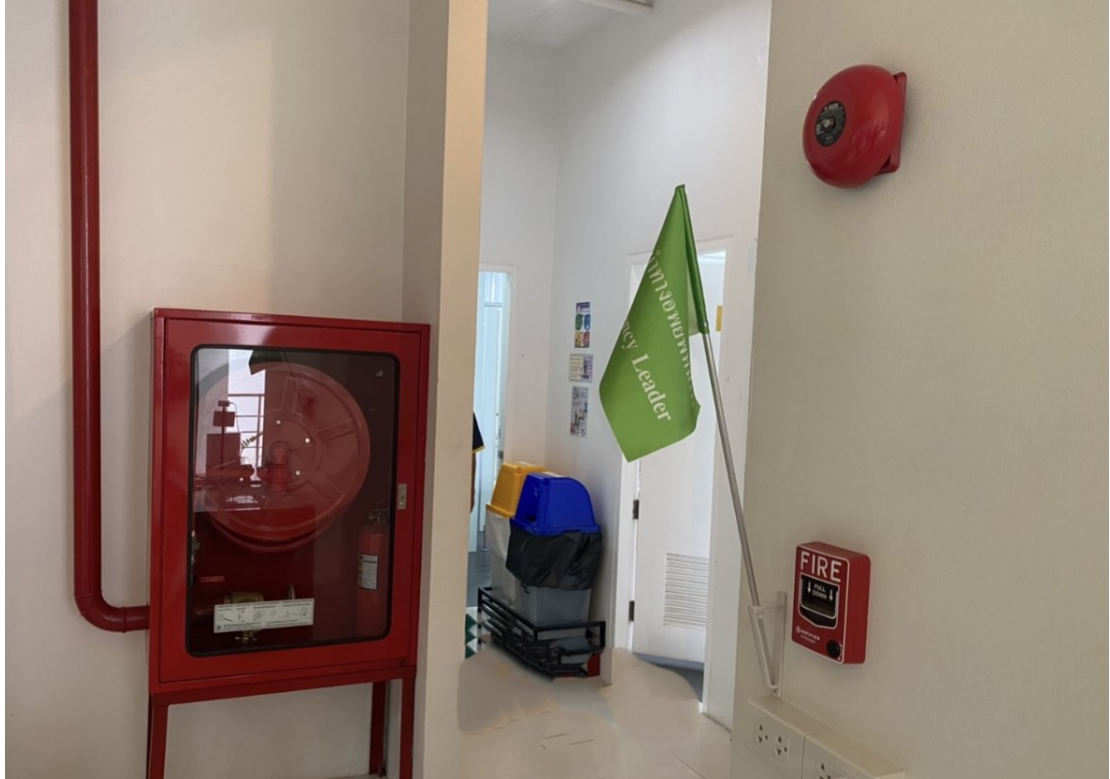
จุดติดตั้งถังดับเพลิง รงนําทวาง และสัญญาณแจ้งเตือน (ชั้น 3) บริเวณหน้าห้องจัดเตรียม สำนักงานมหาวิทยาลัย [สำนักงานมหาวิทยาลัย อาคาร 2]
