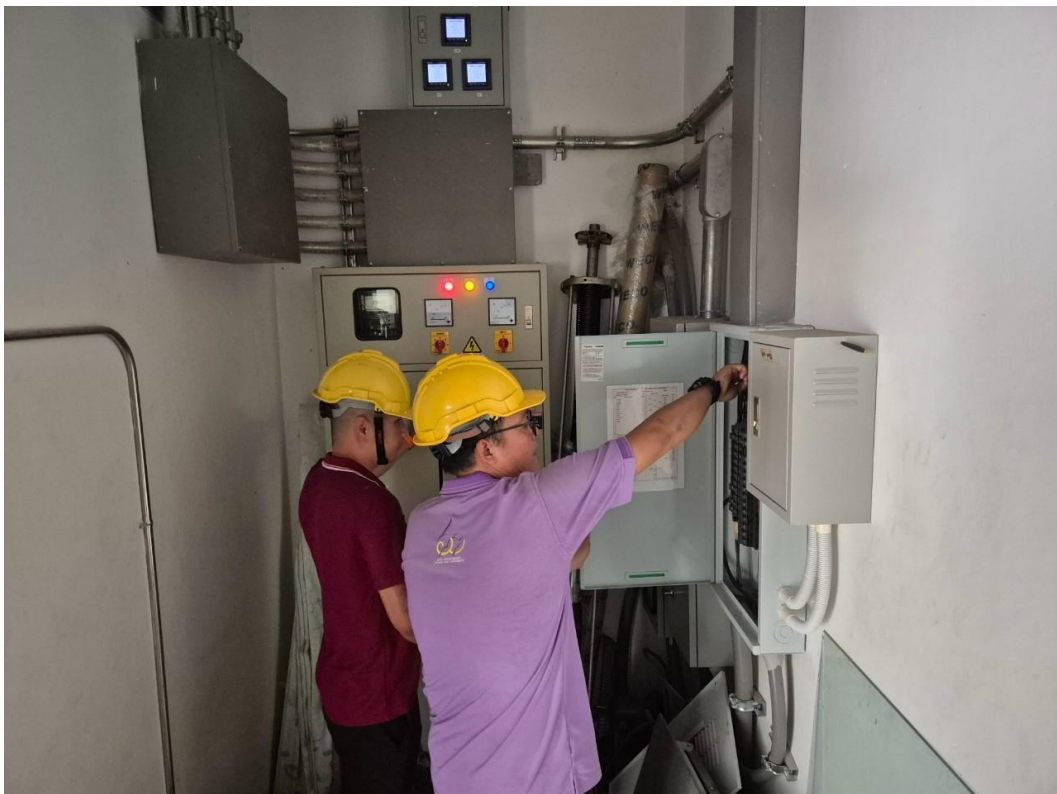
รูป 10 หน่วยดูแลสาธารณูปโภคฉุกเฉิน เข้ามาทำการตัดกระแสไฟฟ้าภายในอาคาร
