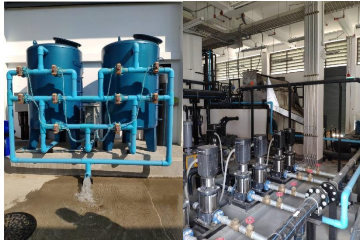
ภาพที่ ๓ การใช้น้ำสำหรับล้างย้อนถังกรอง ล้างระบบท่อและเครื่องจักร
