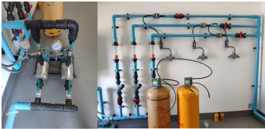
ภาพที่ ๑ ระบบคลอรีนที่ใช้น้ำจากการบำบัด
