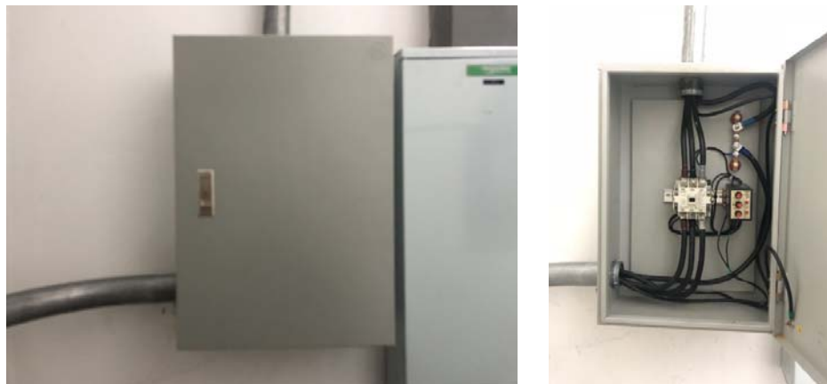
รูปที่ 2.11 รูปภาพระบบกันกระแสไฟย้อนแล้วเสร็จ
