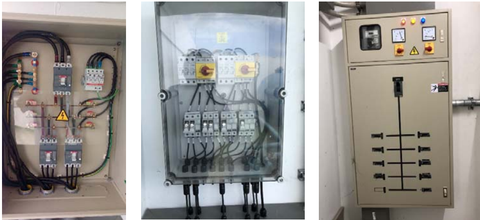
รูปที่ 2.10 รูปภาพระบบไฟฟ้าควบคุมแล้วเสร็จ
